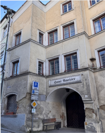
Abb. 74: Stark sanierungsbedürftiges Gebäude Langgasse
