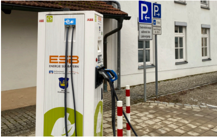
Abb. 40: Öffentliche E-Ladesäule Brunngasse
